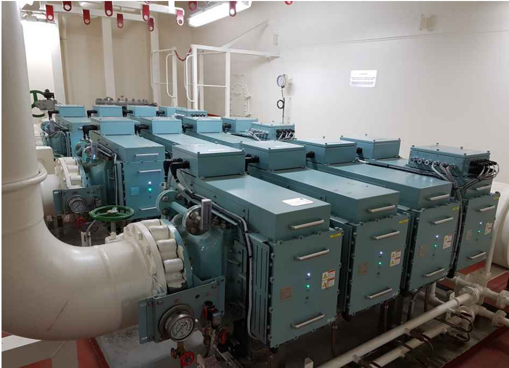
[그림 43] 일반적인 전기분해방식(직접식) 현장설치 예시
